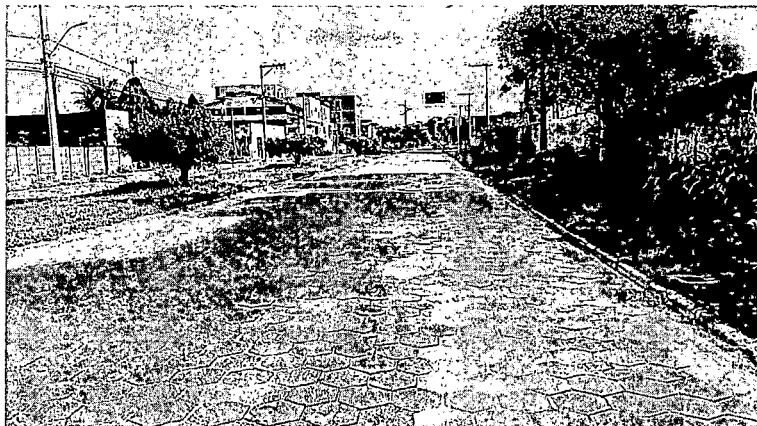
FIGURA 67 - TRECHO COM SINALIZAÇÃO HORIZONTAL INEXISTENTE - AVENIDA RENATO SOARES DOS REIS.
