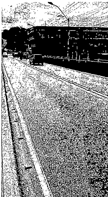
FIGURA 71 - SINALIZAÇÃO HORIZONTAL IDEAL E EM BOM ESTADO DE CONSERVAÇÃO - PONTE CRISTIANO DIAS LOPES.
